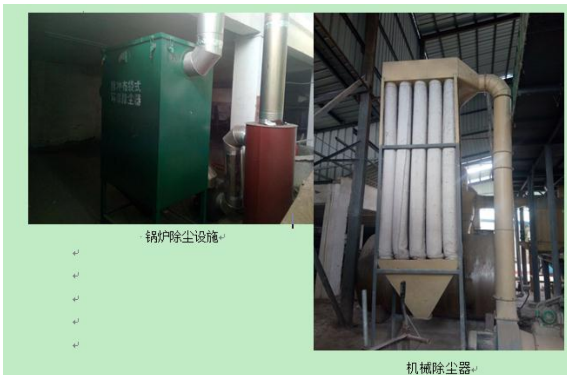
图 4-1 废气治理设施图
