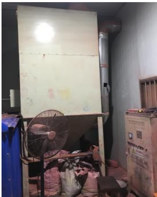
脉冲布袋除尘器（1号车间）
