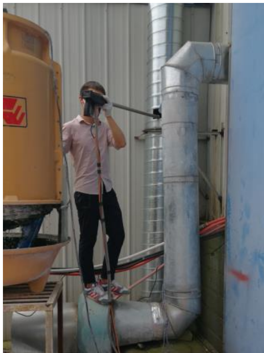
排气筒 G3 出口
