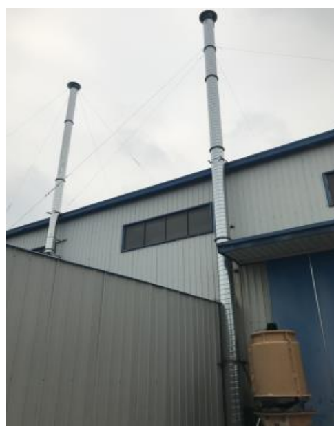
15米排气筒（2号车间）
