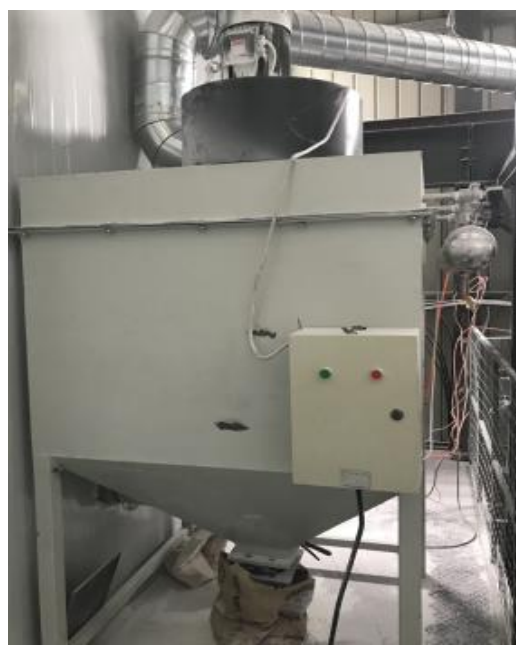
脉冲布袋除尘器（2号车间）
