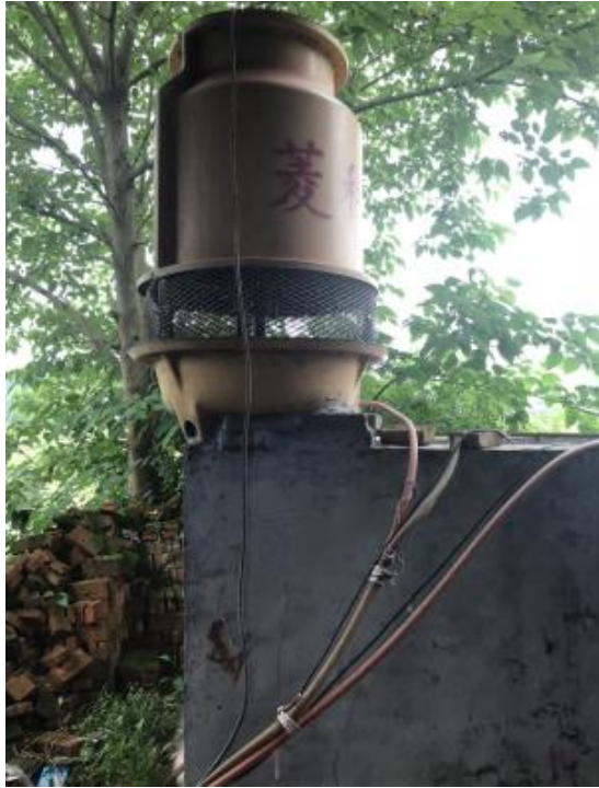
1 号车间冷却塔
