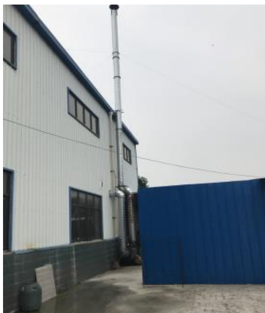
15米排气筒（1号车间）
