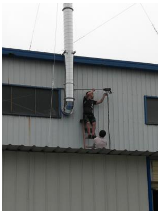
排气筒 G2 出口
