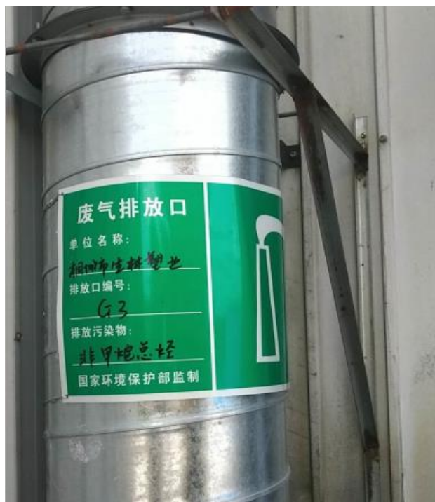
排气筒 G3 标志牌
