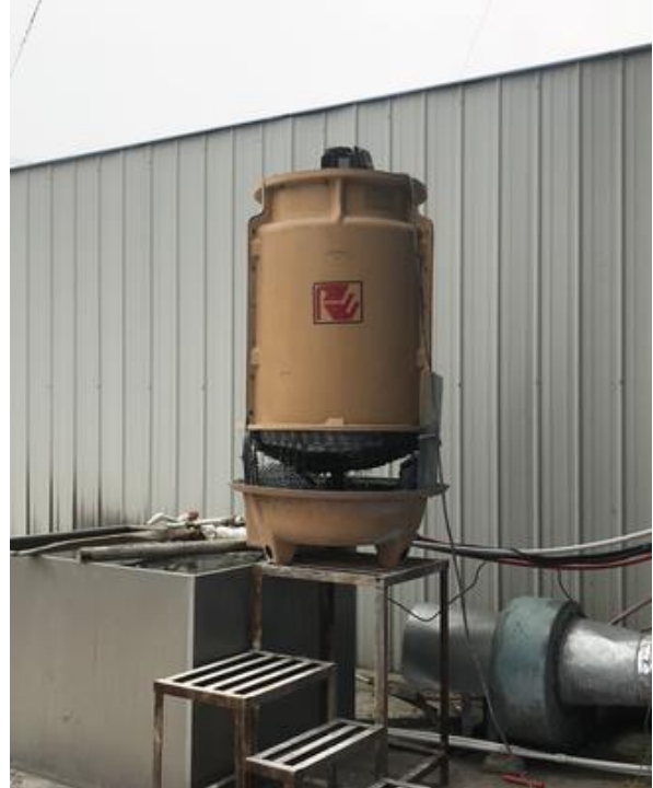
2 号车间冷却塔
