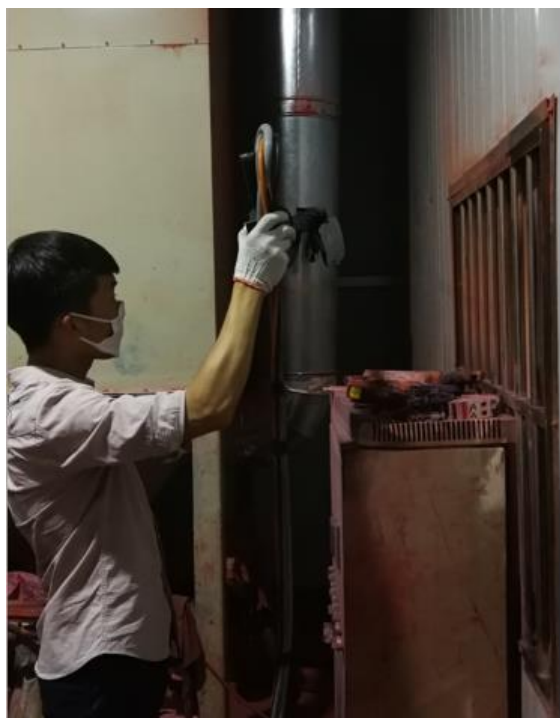
排气筒 G1 进口（颗粒物）
