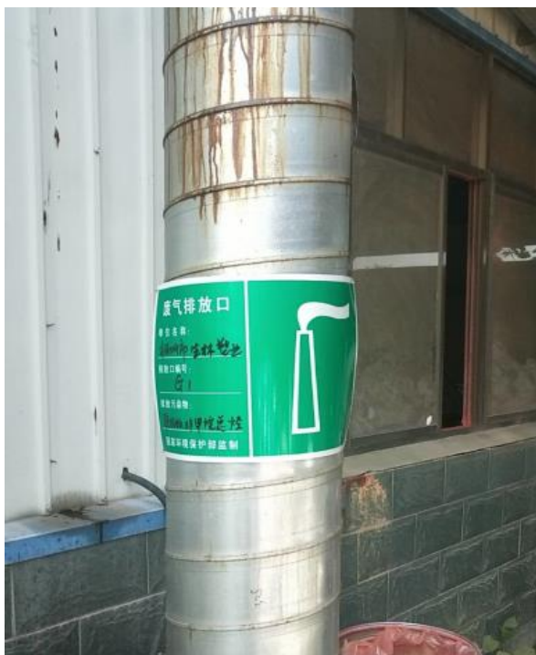
排气筒 G1 标志牌
