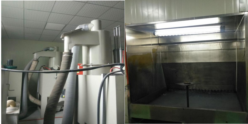
喷砂设备废气进口
