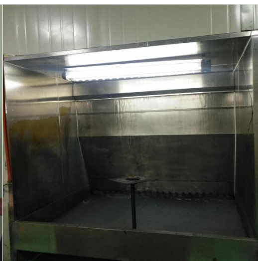
涂覆室水帘除雾装置
