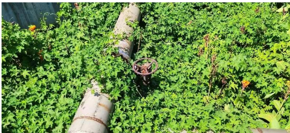
图 3-4-1 事故池及切断阀图片
